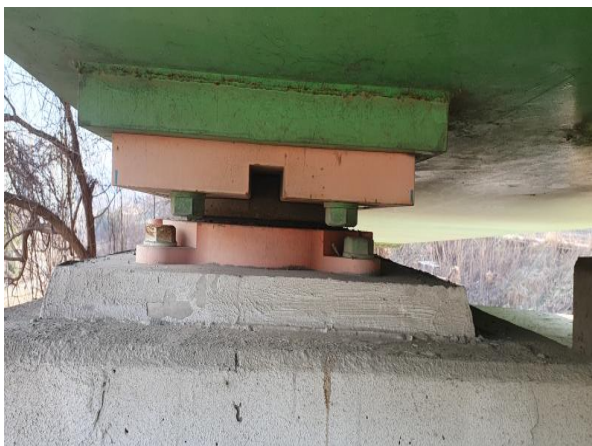
P1 받침 부식 임시조치(재도장) 전 현황
